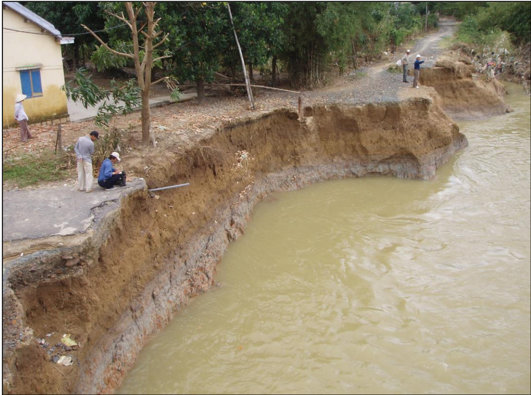
V.14. Xói lở bờ phải sông Cái Ninh Hòa, đoạn xã Ninh Phú
